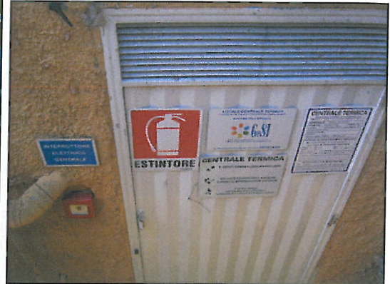
Ingresso centrale termica
