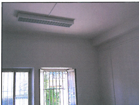
Particolare impianto illuminazione
