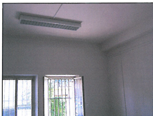
Particolare impianto illuminazione
