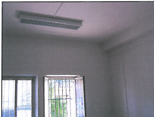
Particolare impianto illuminazione
