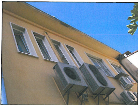
Lato nord con vista impianti clima
