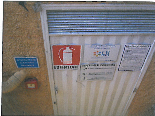
Ingresso centrale termica
