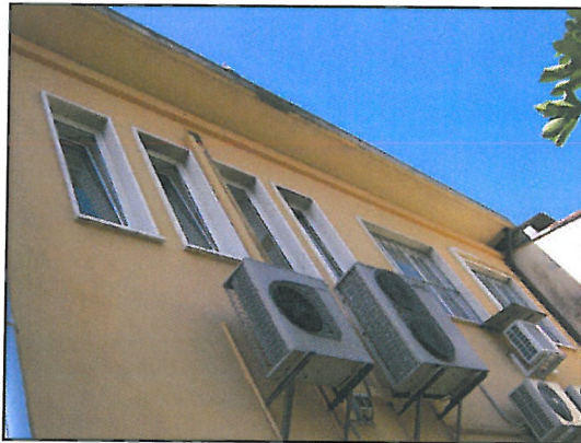
Lato nord con vista impianti clima
