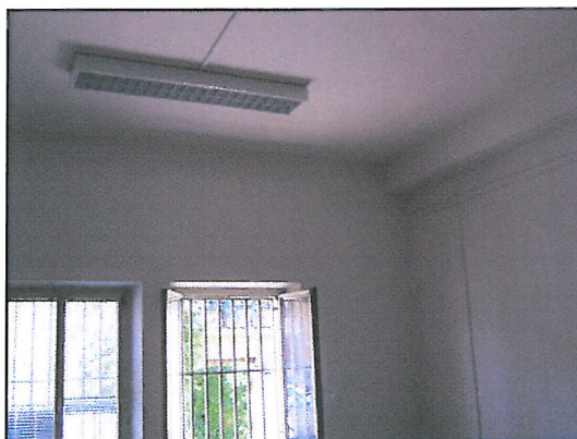
Particolare impianto illuminazione
